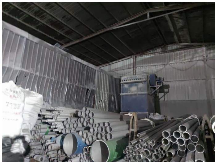
布袋除尘废气处理设施
