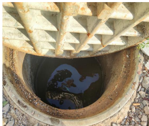
消毒后出水池
