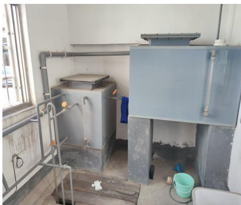
污水处理加药装置
