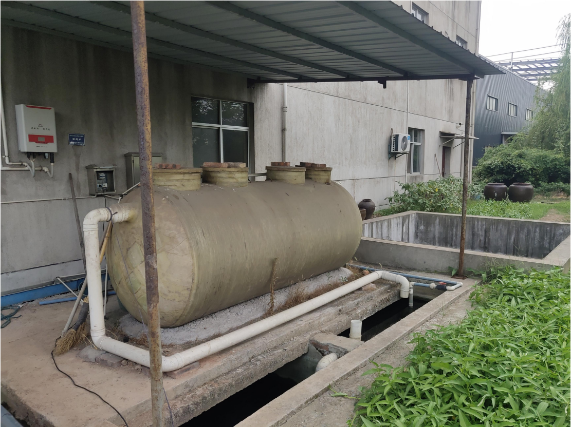
图 4-2 项目污水处理设施
